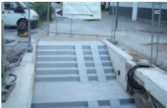
Eine neue Stiege mit Zwischenpodesten sorgt für bequemes und sicheres Treppensteigen.
