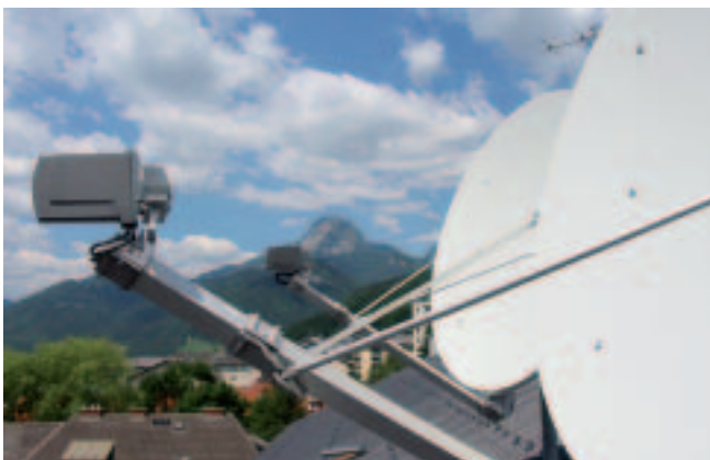
Die Empfangsanlagen der IG-SAT
