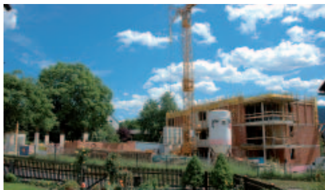
Zügig voran schreiten die Bauarbeiten für die Errichtung eines weiteren Seniorenwohnheimes durch die Siedlungsgenossenschaft Ennstal an der Salzstraße 23 – 25. Die Übergabe der insgesamt 21 seniorengerecht ausgestatteten Wohneinheiten wird im Frühjahr 2008 erfolgen.
