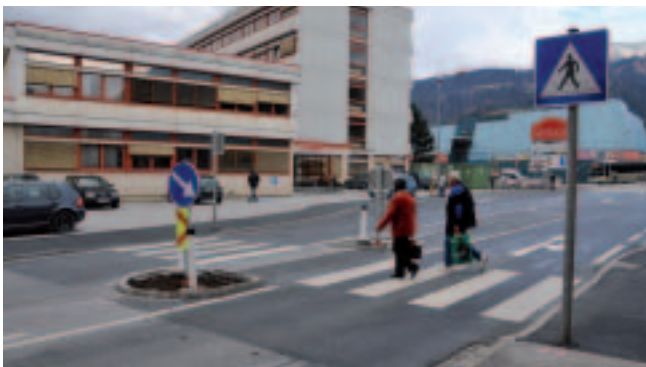
Südlich des Kreisverkehrs auf Höhe des Finanzamtes wurde für die Passanten ein neuer Fußgängerübergang angelegt.
