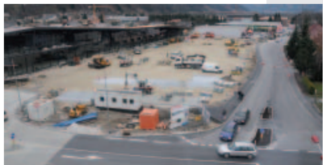
Die Werkstraße wurde, beginnend von der Hauptstraße bis zur Pyhrnbachbrücke, generalsaniert und mit einem neuen Asphaltbelag versehen.
