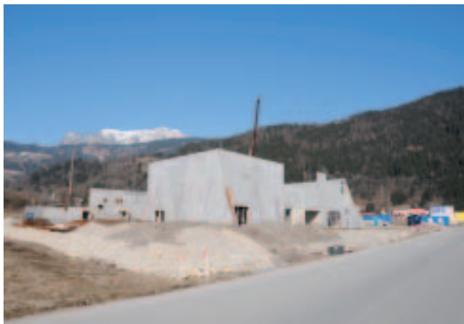
Die Bauarbeiten für die Errichtung des Kinocenters an der Niederfeldstraße schreiten zügig voran. Die Eröffnung des Unterhaltungskomplexes ist für den Frühherbst 2008 geplant.
