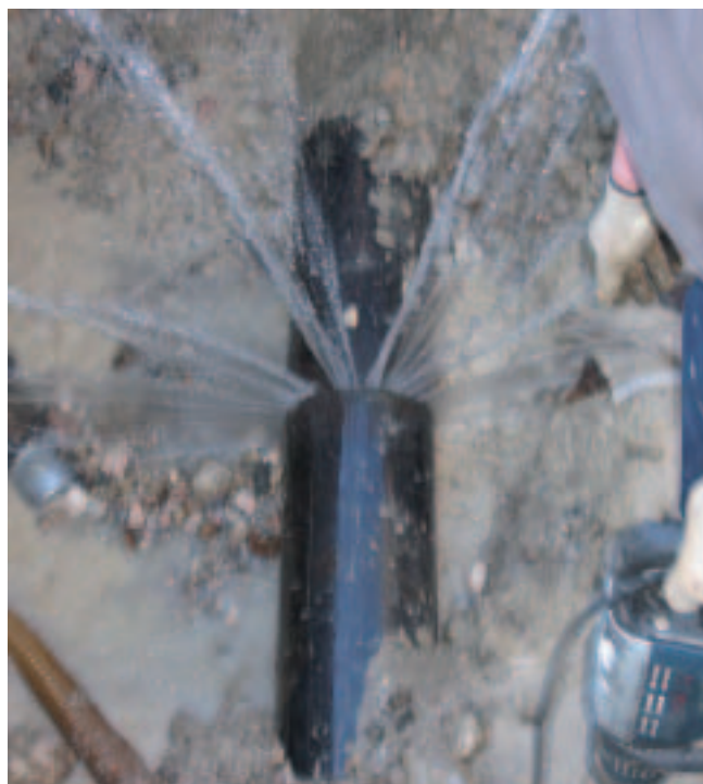
Ein so genannter „gerader Riss“ in der im Durchmesser 20 cm starken Versorgungsleitung von der Rotkogelquelle in Weißenbach nach Liezen auf Höhe des Spar-Marktes in der Ausseer Straße.
