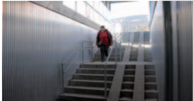
Der Zugang von Süden ist nunmehr ohne die Überwindung von Stufen möglich. Im Norden wurden zur besseren Begehrbarkeit Stiegenpodeste und Kinderwagenspuren eingebaut. Durch die Verwendung von Glaselementen und einer Aluverkleidung erscheint der Durchgang hell und ansprechend.
