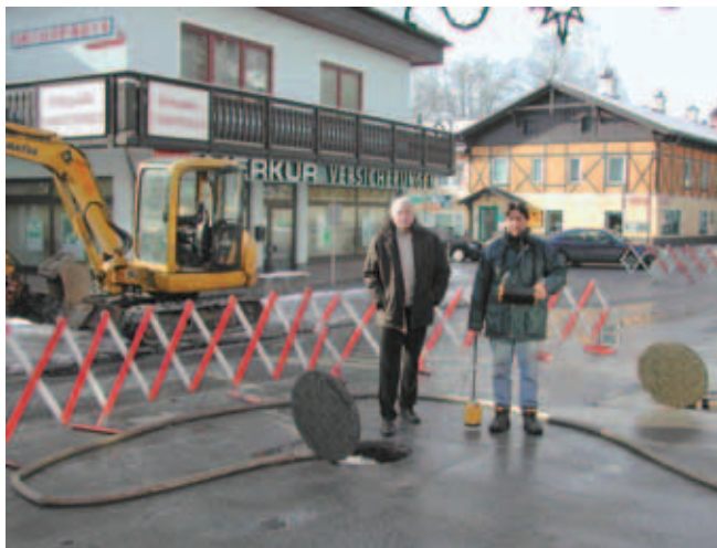
Bürgermeister Rudi Hakel erkundigt sich vor Ort bei Michael Essenko über den Stand der Reparaturarbeiten.
