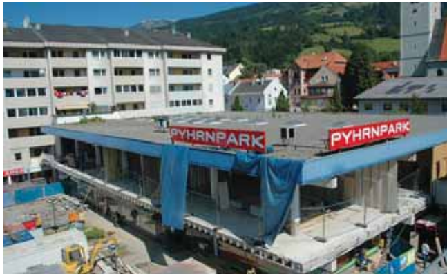
Nach Entfernung der Glasfassade wird mit der Montage der zukünftigen Außenwand-Elemente begonnen.
