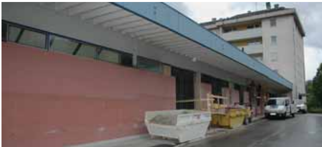
Die Nordfront wird für den Einbau des Eingangsportales und zusätzlicher Fenster geöffnet.
