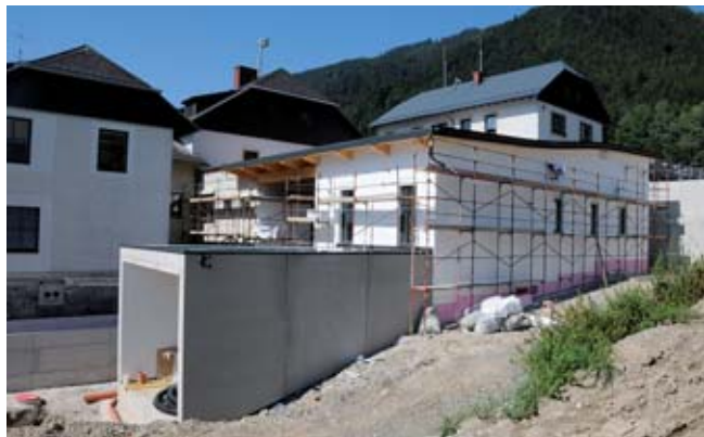
In diesem neu errichteten Zubau bei der Mautstelle im Reithtal wird eine der modernsten Tunnelwarten Österreichs installiert.
