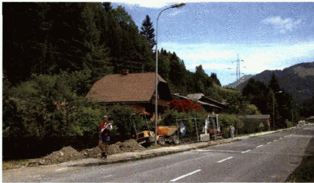
Im Pyhrn wird zur Zeit an der Verstärkung eines Abschnittes der Wasserversorgungsleitung gearbeitet.
