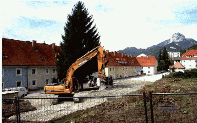
Im nördlichen Innenhof des Dr.-Karl-Renner-Ringes wurde von der Siedlungsgenossenschaft Ennstal mit den Arbeiten für die Errichtung von zusätzlichen PKW-Abstellflächen begonnen.
