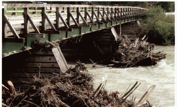
Das Treibgut beschädigt die Überführer-Brücke derart, dass diese durch eine neue Brücke ersetzt werden muss.
