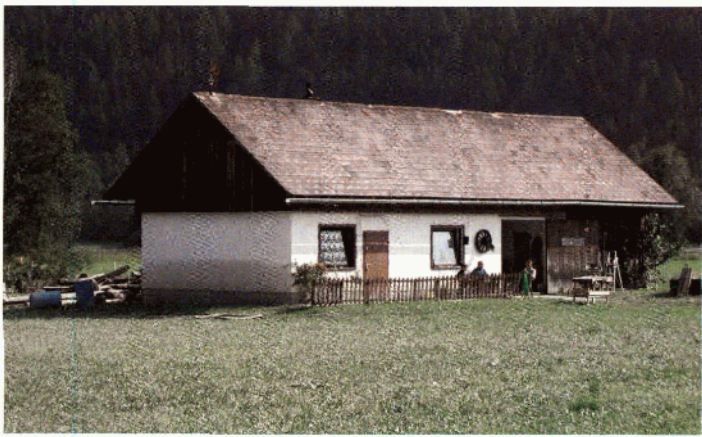
Auch an der Fassade dieses landwirtschaftlichen Gebäudes ist noch die Anschlaglinie des Hochwassers sichtbar.
