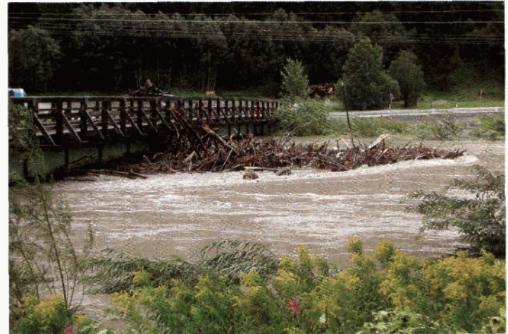
Flussaufwärts sammeln sich Tonnen von Freibholz an. Die Gefahr einer Zerstörung der Überführer-Brücke steigt stündlich.
