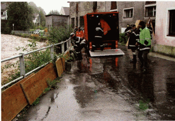
In den Morgenstunden des 12. August beginnt die Feuerwehr beim Pyhrnbach mit der Errichtung von Schutzdämmen.
