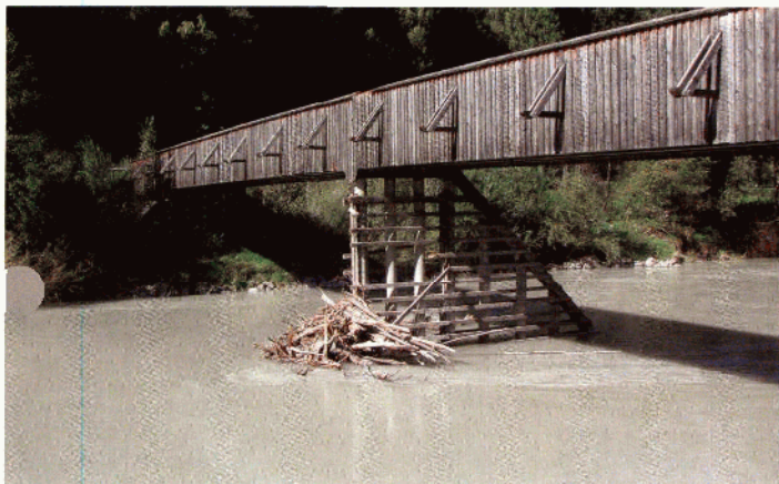
Im Reitthal wird die Radwegbrücke beschädigt. Die fehlenden durch Treibgut abgerissenen Stützen flussaufwärts sind deutlich zu erkennen.
