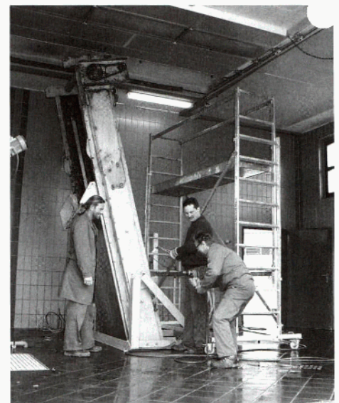
Die Kläranlage ist stets auf dem neuesten technischen Stand.
