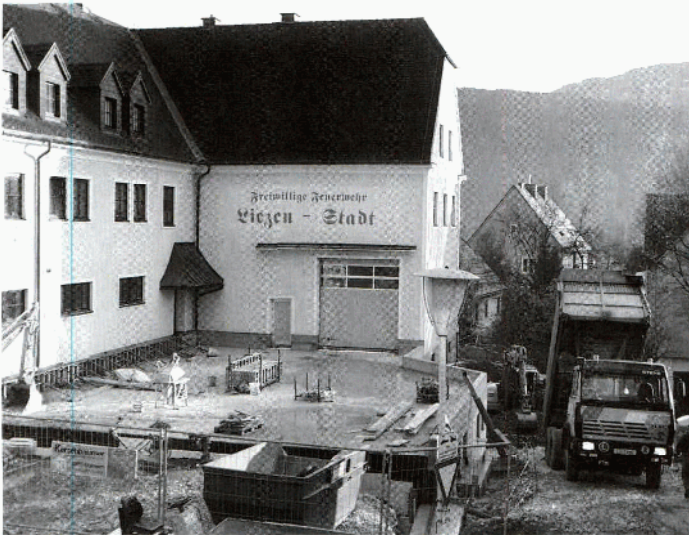
Der Rohbau für die Erweiterung des Kellergeschosses beim Feuerwehr-Rüsthaus ist bereits fertiggestellt
