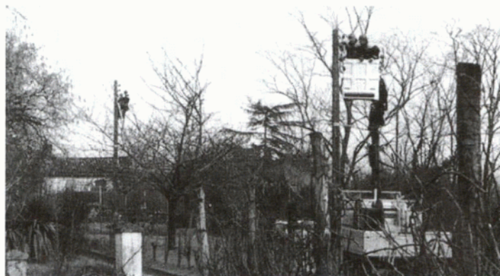
Diese Transformatorstation in einem Weingarten wurde ebenfalls wieder instandgesetzt.
