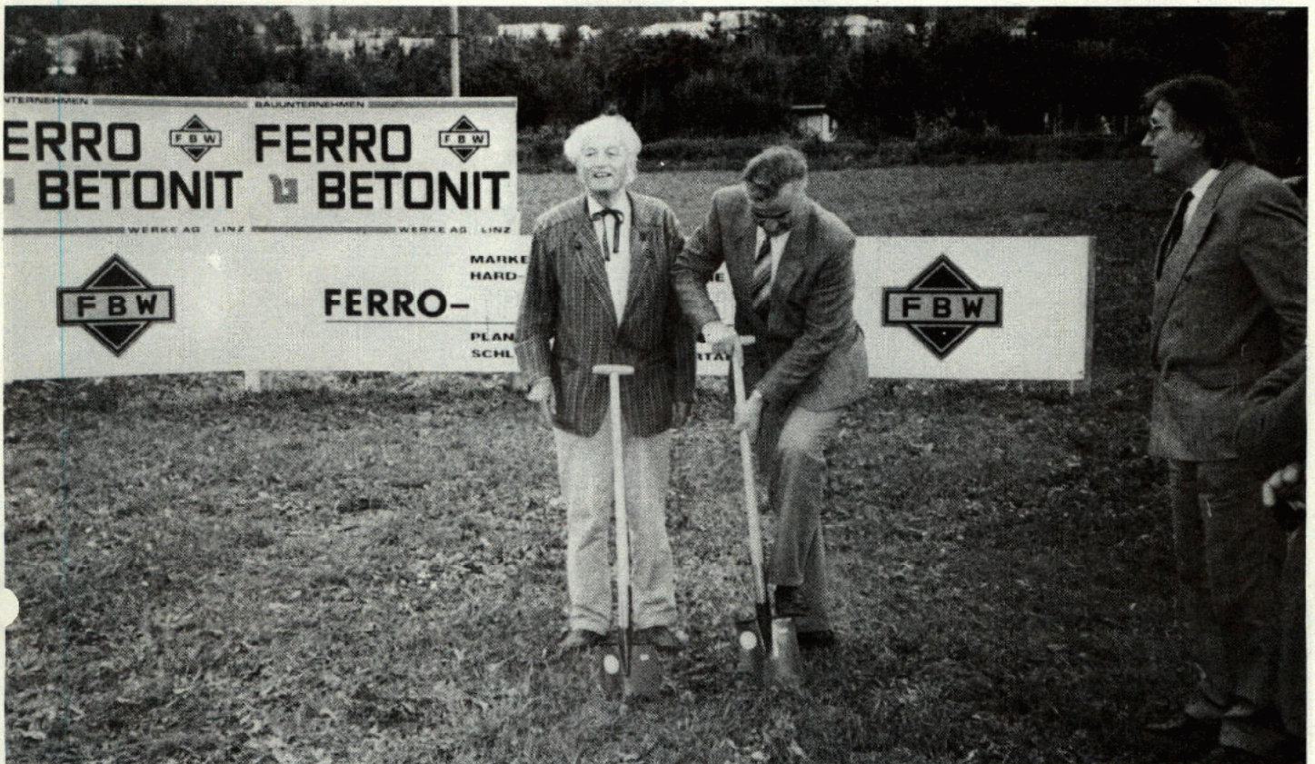
Bezirkshauptmann Hofrat Dr. Meier und Bürgermeister Kaltenböck beim Spatenstich. Rechts: Der zukünftige Geschäftsführer der Betreibergesellschaft Ing. Walter Heigl
