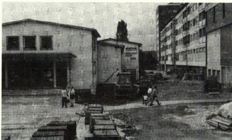
Die „Wohnstraße“ im Viertel Volkshaus-Schule soll bis zum Nationalfeiertag (26. Oktober) fertig gestaltet sein.
