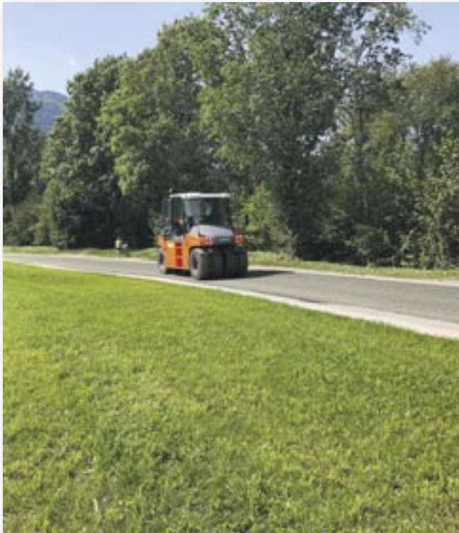
In den vergangenen Wochen waren die Mitarbeiter des Städtischen Bauhofes unter anderem mit Straßen-Oberflächen-Sanierungen beschäftigt.
