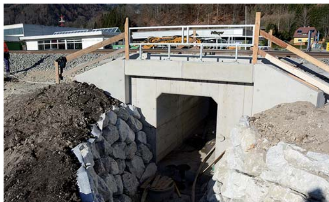
Ebenfalls bereits fertiggestellt ist die Fußgängerunterführung bei der Eisenbahnkreuzung auf Höhe des Autohauses Pfleger.
