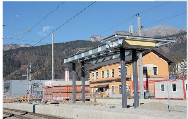
Entlang des Bahnsteiges werden bereits die ersten Bauteile für die neue Überdachung errichtet.
