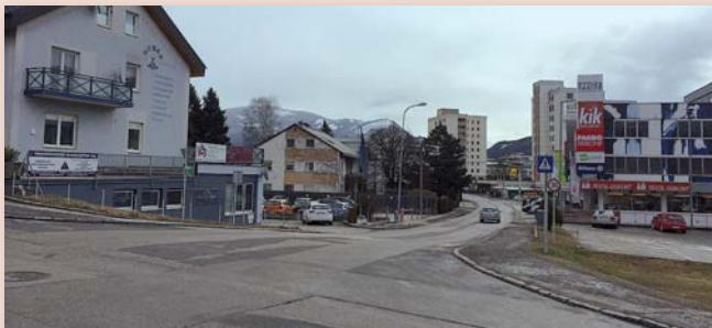
Nach den umfangreichen und für die Passanten unangenehmen Aufgrabungen für die Nahwärmeversorgung im Vorjahr wird der Fronleichnamsweg heuer generalsaniert.
